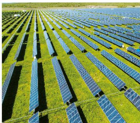
L'energia solare viene sfruttata direttamente nei pannelli fotovoltaici, che trasformano l'energia luminosa in energia elettrica.
